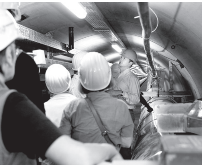
Trockenen Fußes unter der Förde hindurch: Im begehbaren Tunnel verlaufen zwei Fernwärmehöhle, ein Starkstromkabel sowie Kommunikationsleitungen.
