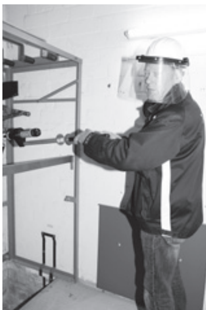
Schaltmeister Gerd Becker überprüft die Netzstation: Der Fehler muss lokalisiert werden.
