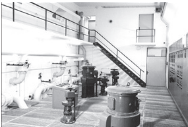
Über dem Reinwasserbehälter befindet sich die Maschinenhalle mit Filteranlagen und Pumpen.
