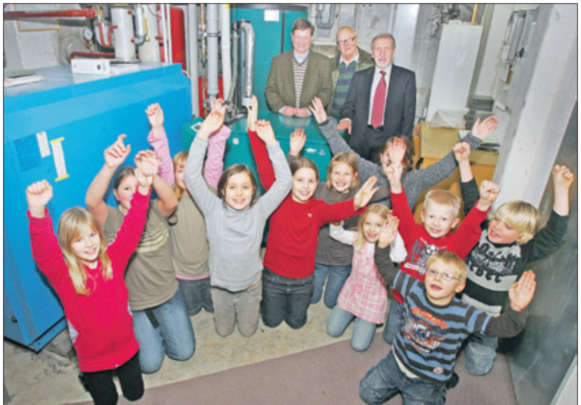
Mini-Blockheizkraftwerke für Schulen: Ziel ist es, alle städtischen Schulen außerhalb des Fernwärmenetzes mit kleinen BHKW auszustatten.
