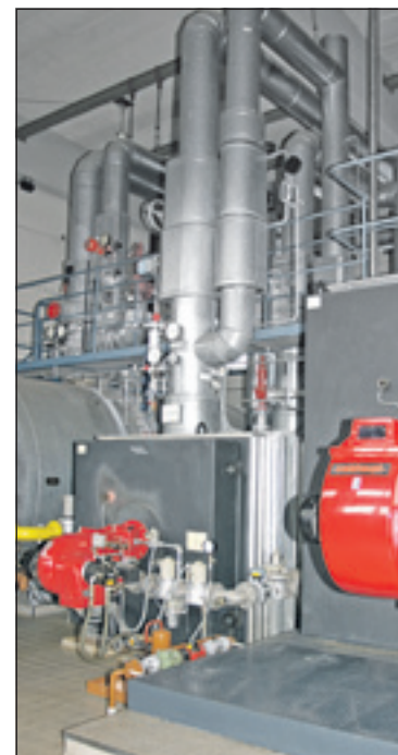
Wird ausgetauscht: Die veraltete Heizungsanlage wird später durch eine neue Fernwärmeübergabestation ersetzt.
