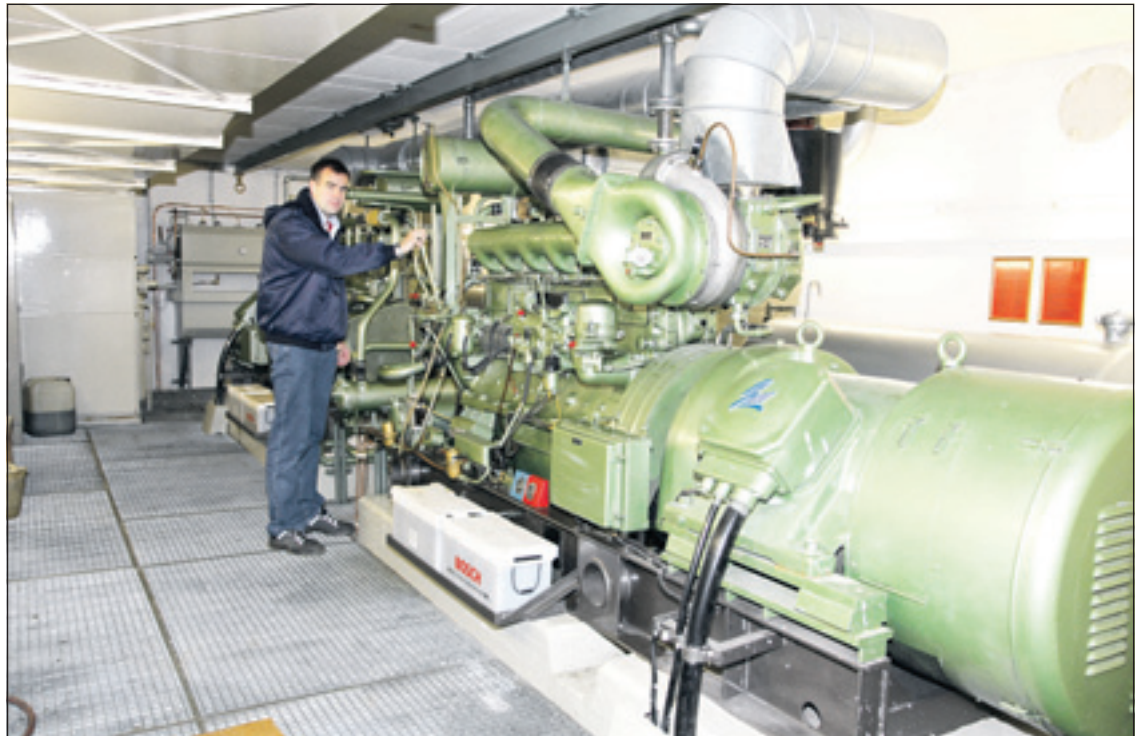
Tägliche Inspektion: Auch wenn das Werk nicht ständig besetzt ist – die ständige Kontrolle durch die Stadtwerke-Mitarbeiter steht auf dem Plan. Hier Gunnar Bandholz am Notstromaggregat.
