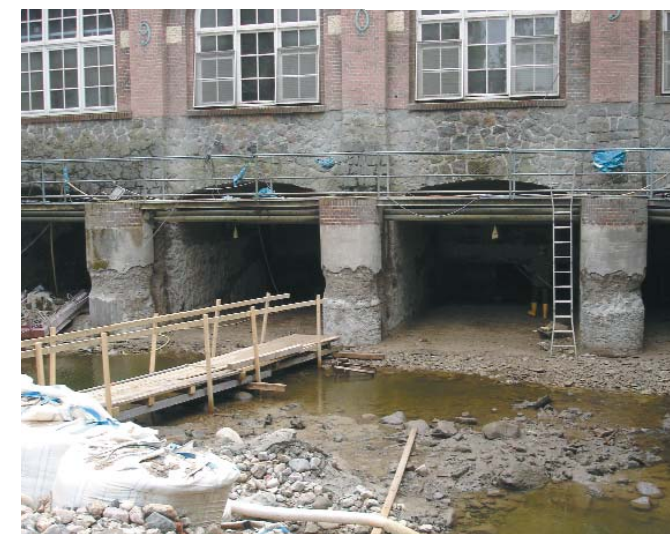
Hober Sanierungsbedarf: Die Turbinenkammern auf der Unterseite des Kraftwerks.
