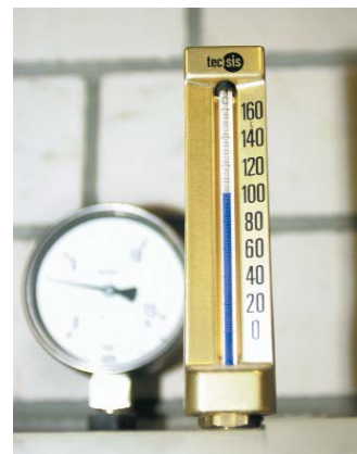
Die Fernwärme der Stadtwerke erreicht IKEA mit einer Temperatur von gut 100 °C.
