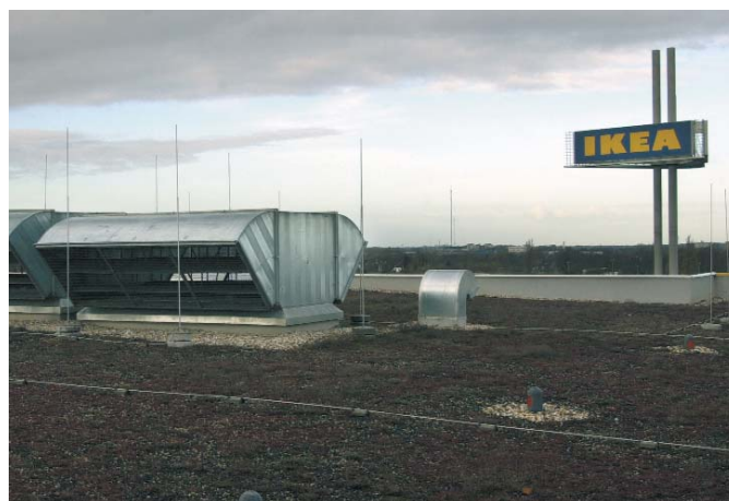
Unter dem Dach von IKEA stehen die Anlagen, die die Wärme liefern.
